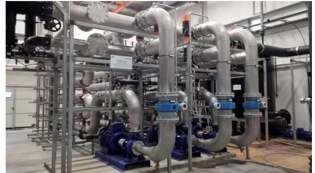
WWTP BIOCOM Несвиж , Ультрафильтрация
