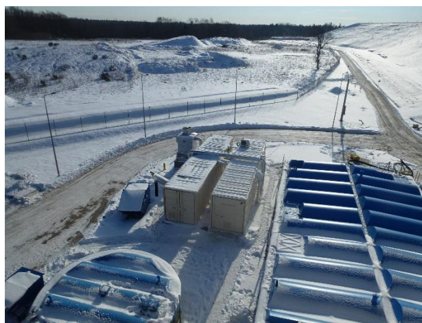
Мусорный полигон для отходов „ЕcoDolina“, Польша, контейнерная установка очистки фильтрационной воды
