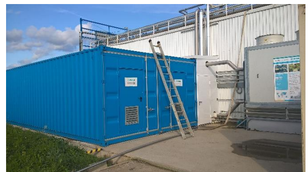
WWTP Home&PersonalCare, L'Oréal, Russland
