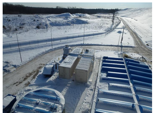
Deponie EcoDolina, Polen, Sickerwasserreinigungsanlage im Container
