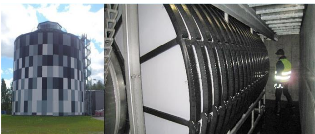
Очисні споруди м. Тарту / Естонія
